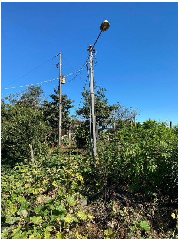
Figura 1: Rede elétrica disponível junto ao imóvel onde será perfurado o poço.
