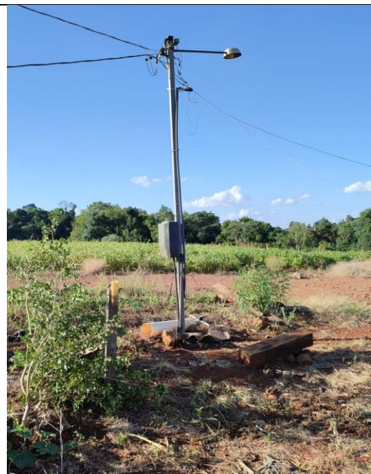
Figura 5: Rede elétrica próxima ao ponto de perfuração do futuro poço.
